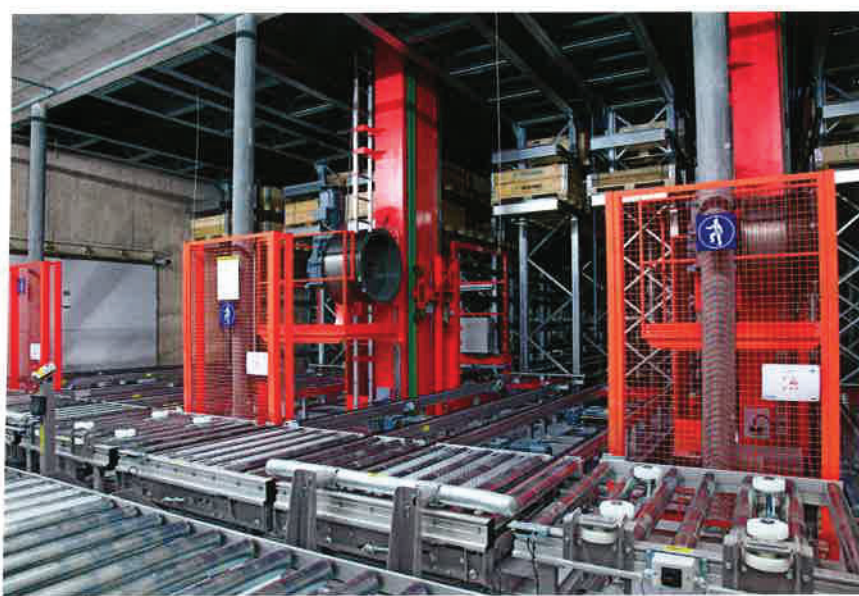
Der Kopfbereich des Paletten-Hochregallagers.
